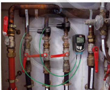
Для предотвращения легионеллеза: проверить сеть горячего водоснабжения
